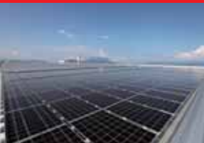
倉庫の屋根を利用した太陽光発電
